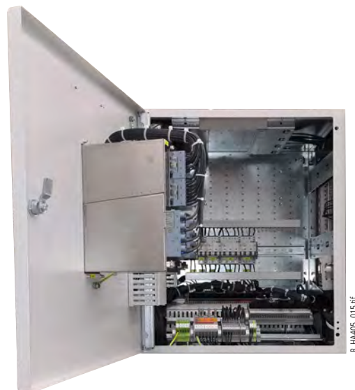
Comparto di bassa tensione aperto con apparecchiature integrate (opzione)
