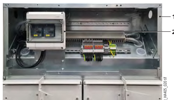
Nicchia di bassa tensione di un'unità di misura di contabilizzazione di tipo M, copertura aperta
